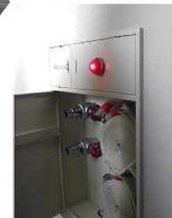
消火栓設備: 放水口 (連結送水管専用)
