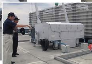
ゴンドラ: 定期ガラス清掃、 窓ガラスの交換時に使用
