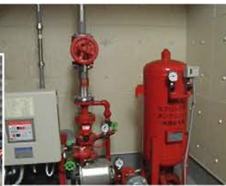
消火水槽: スプリンクラー ポンプユニット
